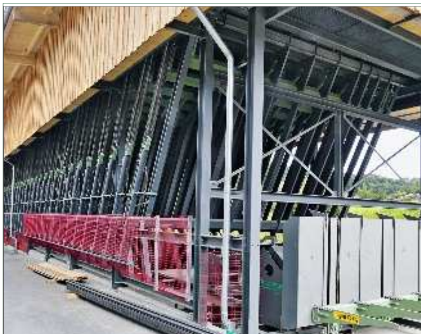
Kalfass-Sortierwerk mit 50 Schrägboxen für Dreifach-Belegung, im Vordergrund die Kippstapelung
